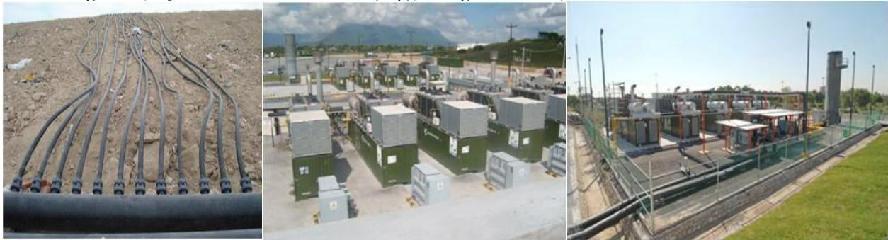
Imágenes 1, 2 y 3. Ductos de conducción (izq.), motogeneradores (centro) y quemador de biogás (der.)
